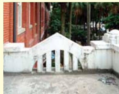
車寄屋頂多處裂縫造成漏水
