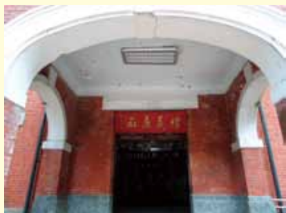
(f) 車寄圓拱與天花出現裂縫
