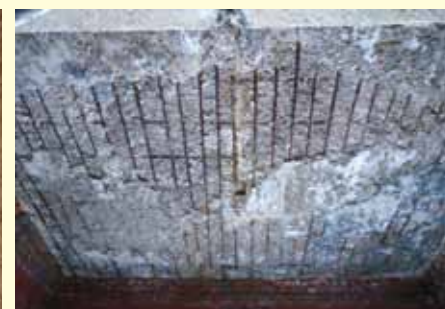
天花保護層剝落且鋼筋外露
